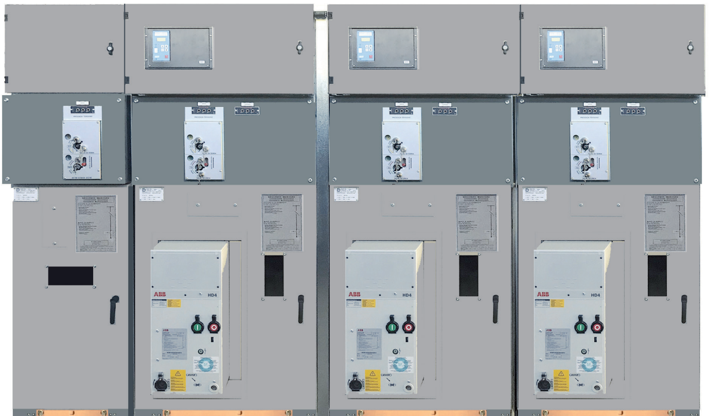
■ Quadro di Media Tensione
